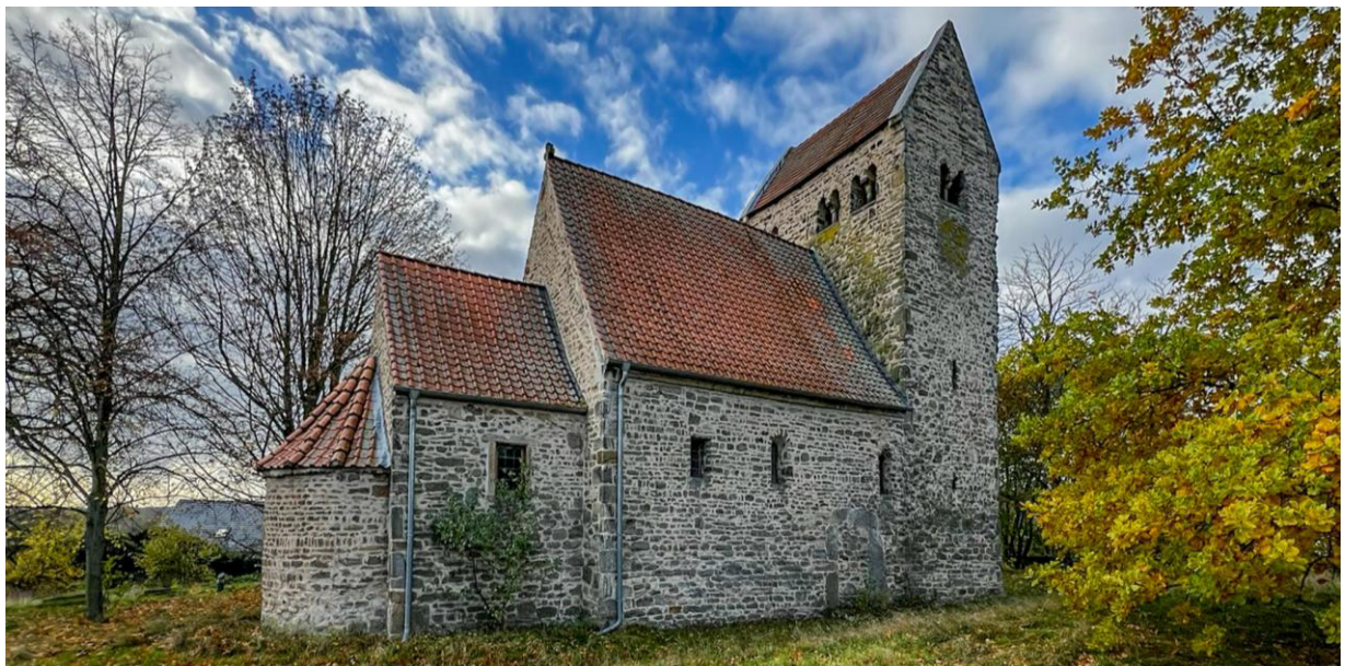
Bild 1: Kirche St. Peter und Paul in Seehausen/Börde von Nordosten. Der geschlossene romanische Baukörper mit Turm, Schiff, Chor und Apsis bildet den Ausgangspunkt der Sicherungsmaßnahmen. Foto: Carsten Sußmann, 14.11.2023.
